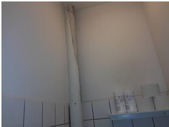
FB02: De standleiding in het toilet is uitgevoerd in gietijzer, eventuele afdichtingen in de moffen zijn niet onderzocht in verband met eventuele lekkages.
