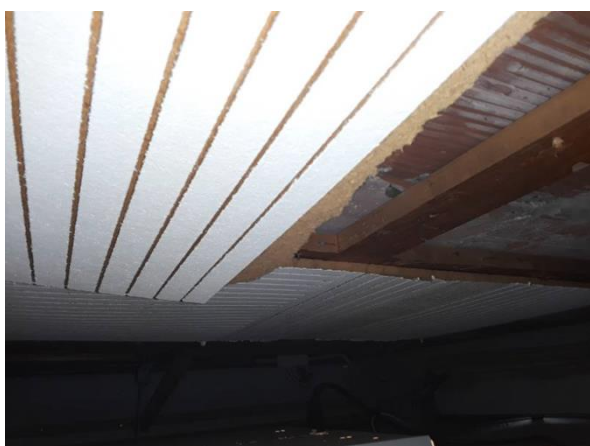
FB04: De oude plafondbeplating boven de systeemplafonds zijn uitgevoerd in zachtboard waarbij er sporadisch een plaat ontbreekt.
