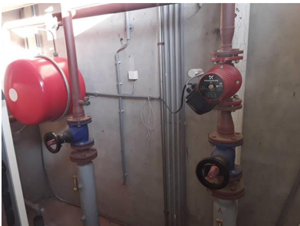
FB08: De pakkingen tussen de flenzen van de CV leidingen zijn niet asbestverdacht aangezien dit gedeelte van de CV installatie is vervangen bij de ketelvervanging in 2000.
