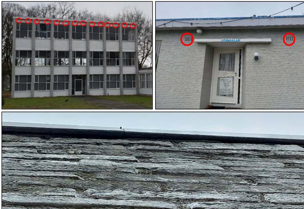
Figuur 4.5. linksboven: open stootvoegen in voormalige kantoorpand. Rechtsboven: ventilatierooster in de bungalow woning. Onder: kierende boeiborden.
