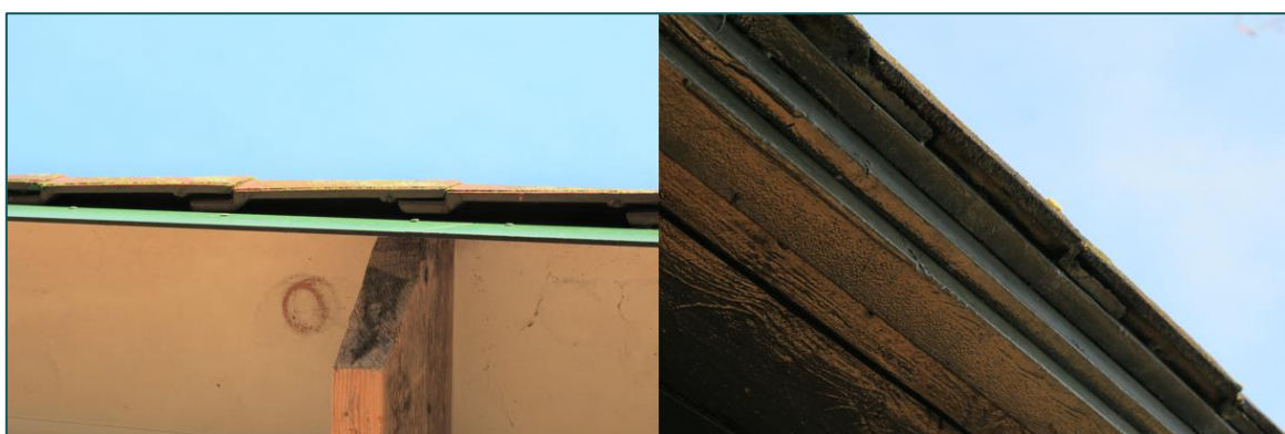
Figuur 3.2 De openingen tussen de kantpannen van de sanitair gebouwen (links) zijn in tegenstelling tot de ruimte tussen de kantpannen van het restaurant (rechts) groot genoeg om gierzwaluwen toegang te verlenen tot de dakruimte.
