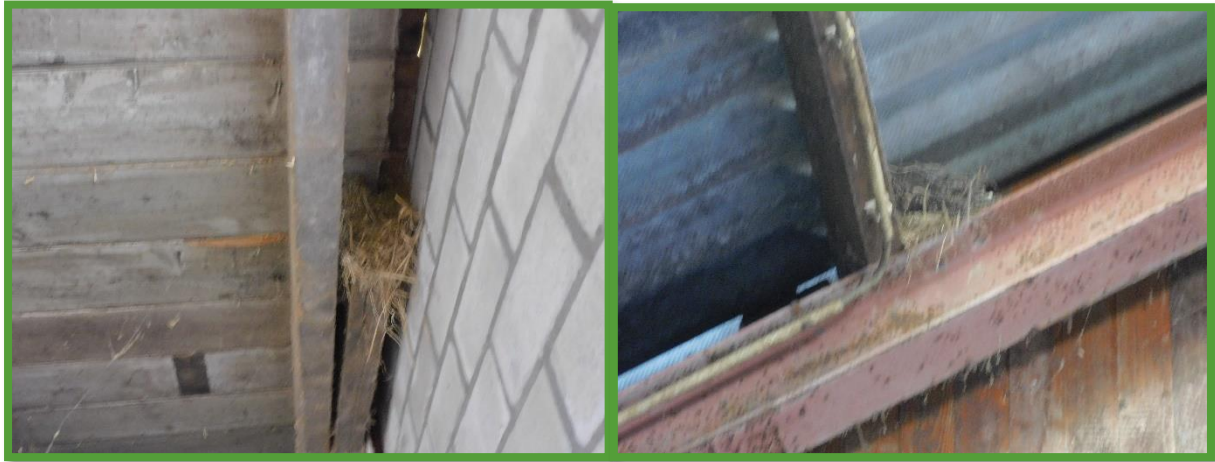
nest van een merel en een duif aangetroffen in de loods
