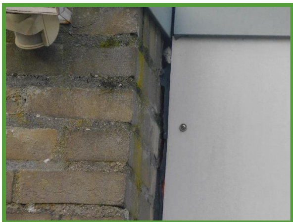
ruimte naast boeiboord en open stootvoeg
