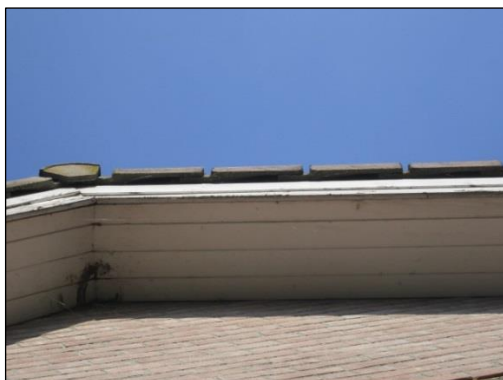
Figuur 7. Resten van Huiszwaluwnesten en ruimte tussen dakpannen kantoorgebouw.
