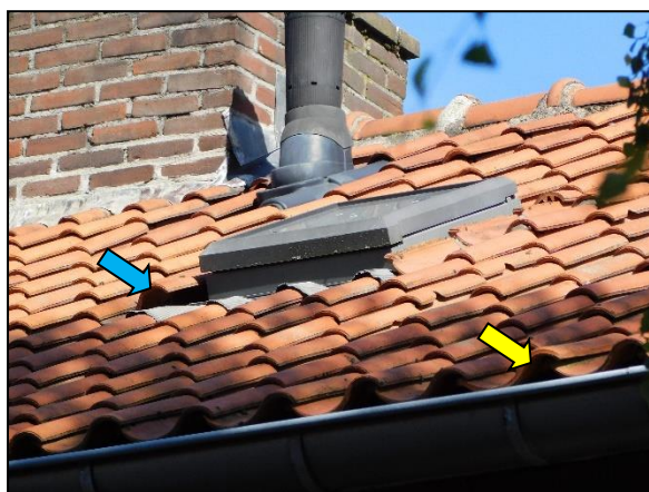
Figuur 9. Ruimte onder de dakpannen via de dakgoot (gele pijl) en los liggende dakpan (blauwe pijl).
