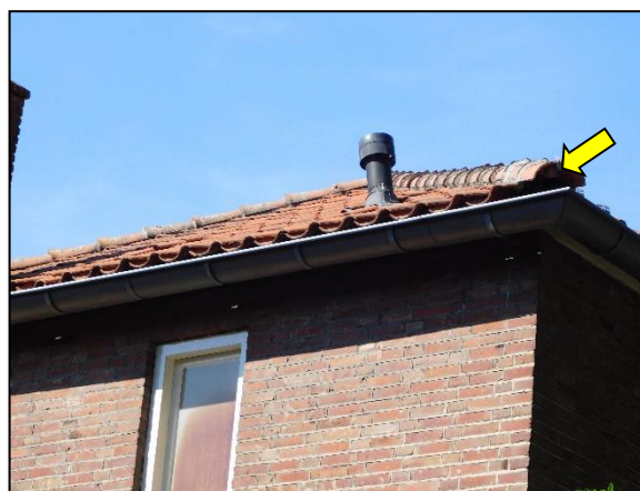
Figuur 10. Opening onder de nokvorst (gele pijl).
