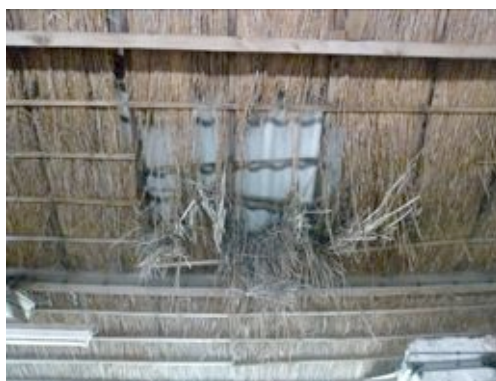
mogelijke sporen van steenmarter in de deel (grupstal); in de varkensstal zijn vergelijkbare sporen aangetroffen
