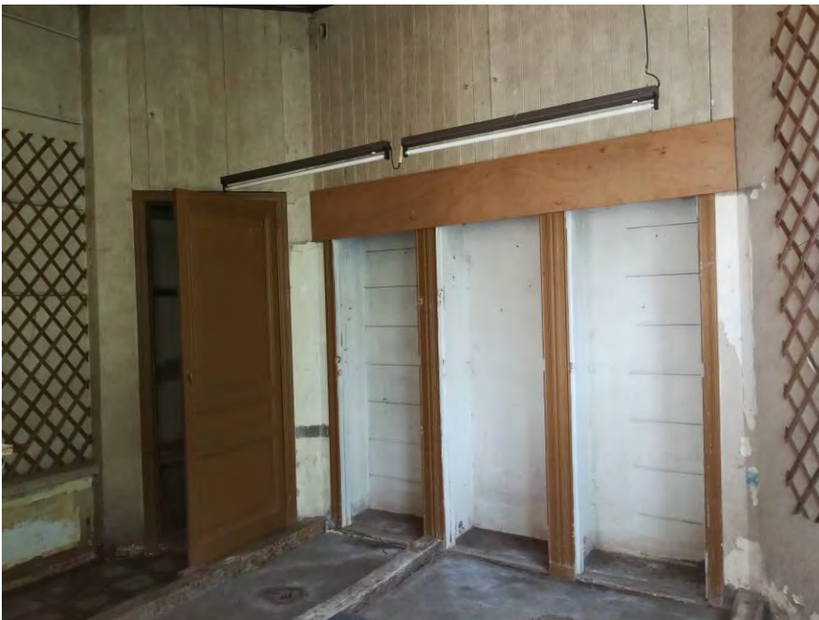
19. Begane grond aansluiting hoofdbouw op vijhoekige vergaderzaal en rechterzijvleugel: het gevelpleisterwerk loopt aan de nu ontstane binnengevels door (links gevel hoofdbouw, rechts in de kasten gevel rechterzijvleugel)
