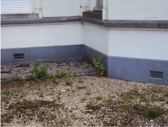
27. Detail aansluiting hoofdbouw en 'vergaderzaal'; kleine verschillen zichtbaar in de uitvoering van de onderdorpel en in de plint opgenomen ventilatioerooster
