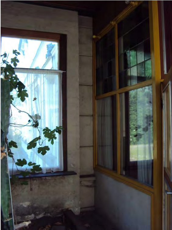
18. Begane grond aansluiting hoofdbouw op vijhoekige vergaderzaal en erker: het gevelpleisterwerk loopt aan de nu ontstane binnengevel door.
