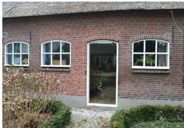
Voormalige loopdeur, vervangen stalramen en vervangen metselwerk.
