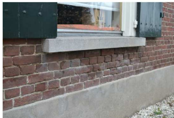
Gecementeerde plint onderzijde van de gevel.
