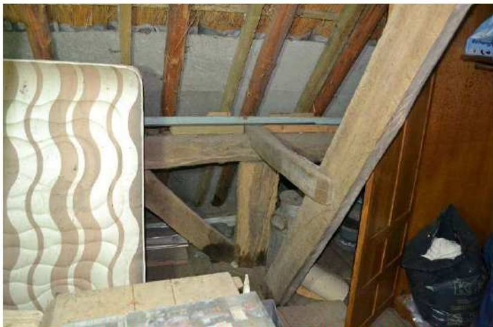
Gedeelte waar rieten dakbedekking overgaat in pannen dakbedekking met (mogelijk asbesthoudende) beplating.
