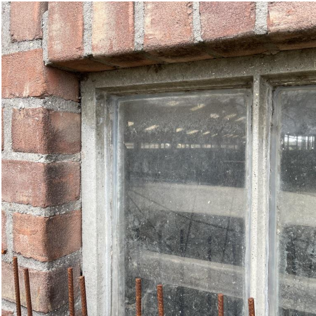
foto 2 stopverf asbestvrij zie M03
