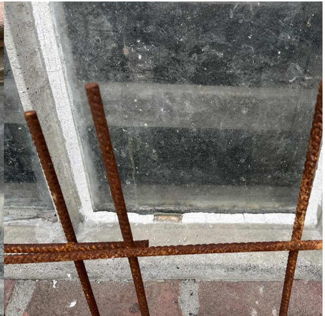
foto 3 stopverf asbestvrij zie M03
