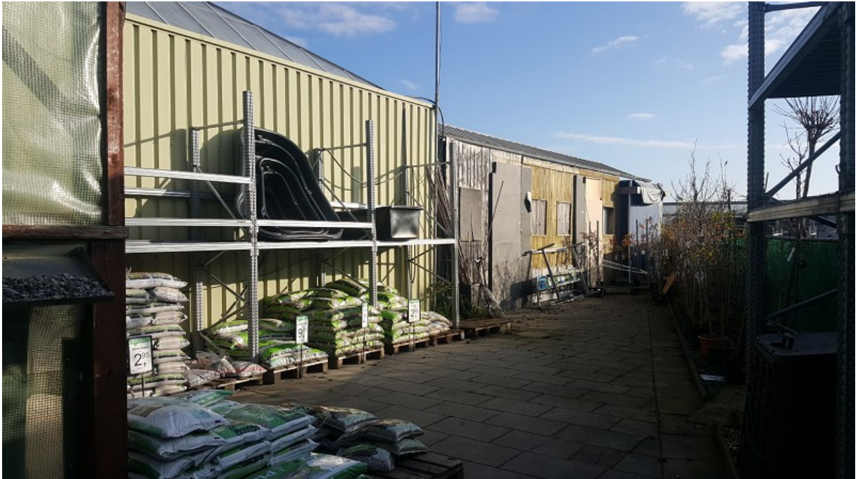
Zuidelijk deel van de westelijke gevel van het tuincentrum. Het rechtse, iets lagere, deel betreft de overkapping. Foto. B. Verhoeven | Ecoresult B.V.
