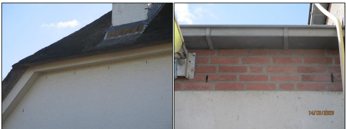
Figuur 2.8. Spouwmuurgaten en rieten dak van woonhuis Heiligenboom 1 (links) en spouwmuurgaten in gebouw van binnenbak (rechts).
