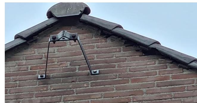
Figuur 11: Openingen bij gevelpannen aan de oostgevel
