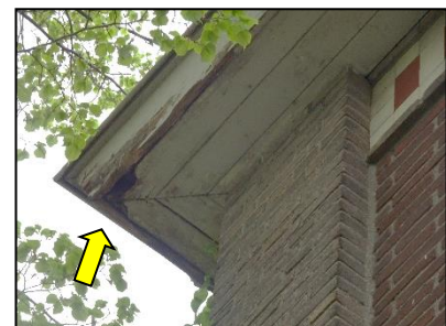
Figuur 9. Gat in de dakbekisting van de voormalige kartonnagefabriek.
