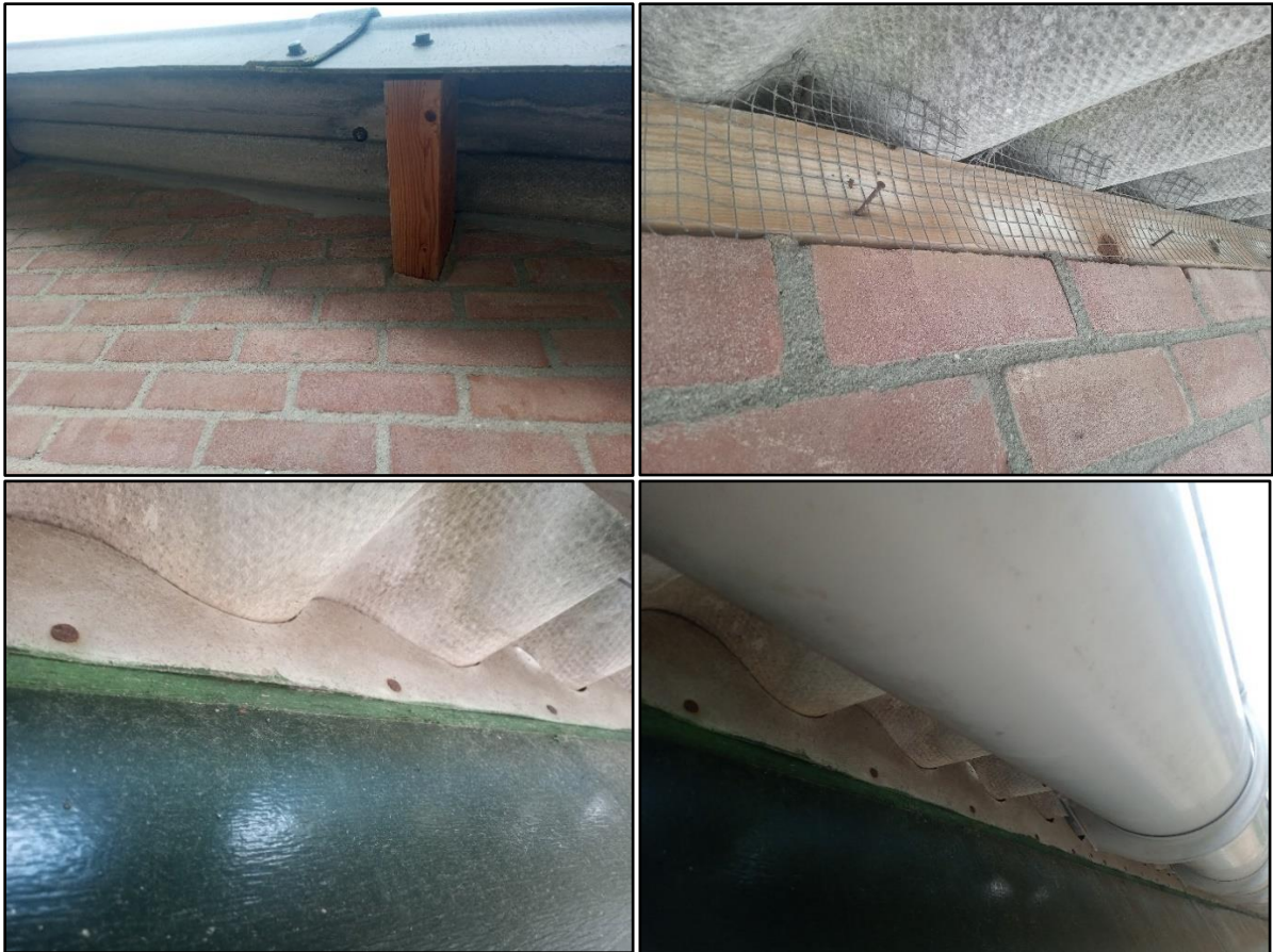
Afbeelding 15: Foto's te slopen stallen
