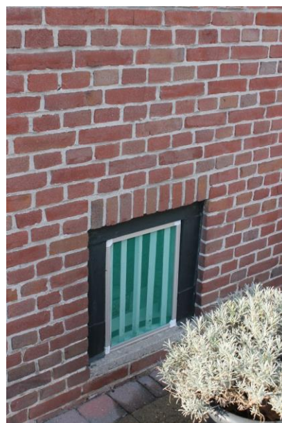
Het gepende keldervenster
