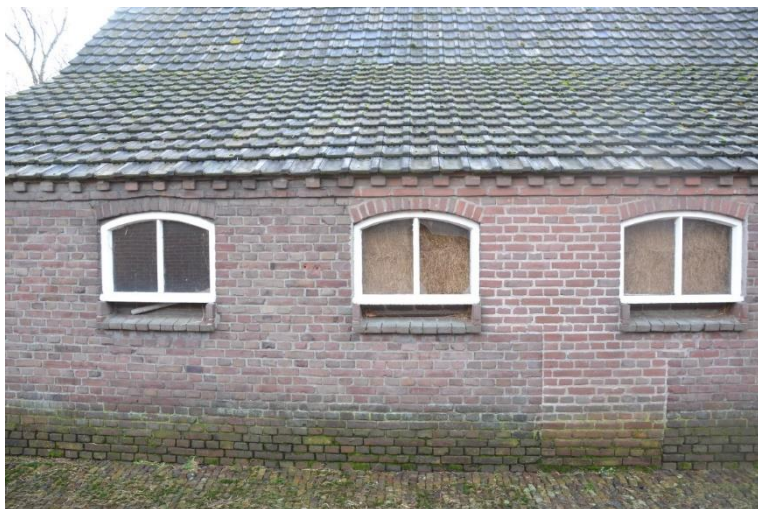
Detail achtergevel van linkerzijbeuk met inboetwerk.
