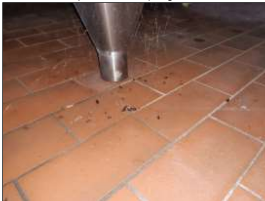
Foto 28 Uitwerpselen onder opslagtank melk
