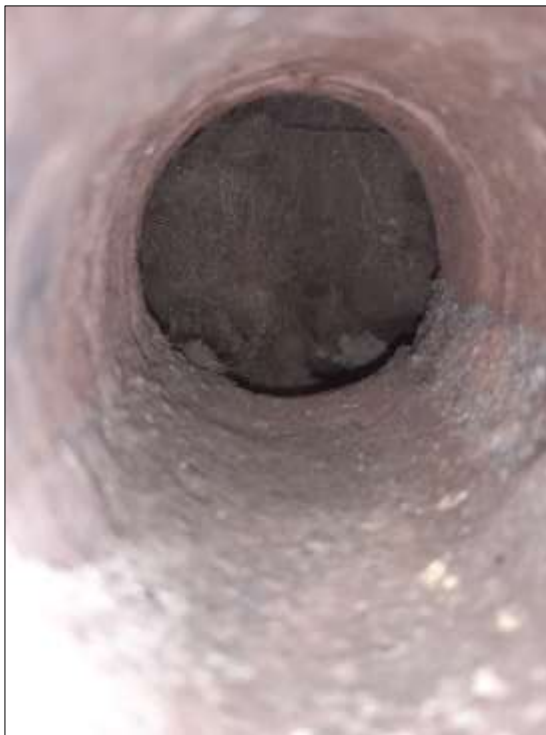
Foto 32 Gat muur aanbouw stal met isolatie
