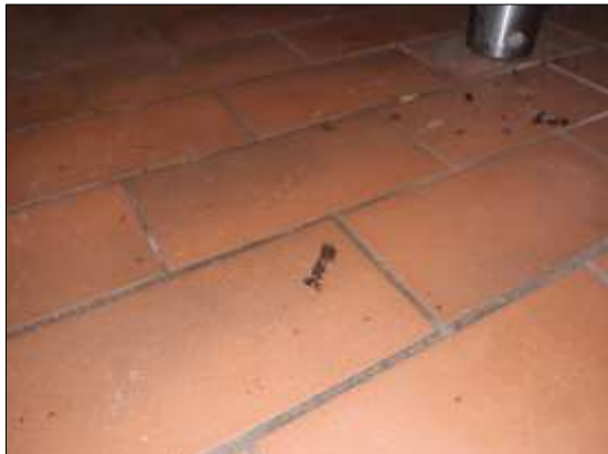
Foto 29 Uitwerpselen onder opslagtank melk
