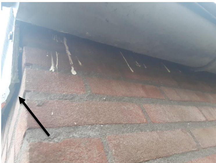
Afbeelding 4.4: Vogelsporen onder dakgoot en kier platte dakbedekking (zwarte pijl) aanbouw.
