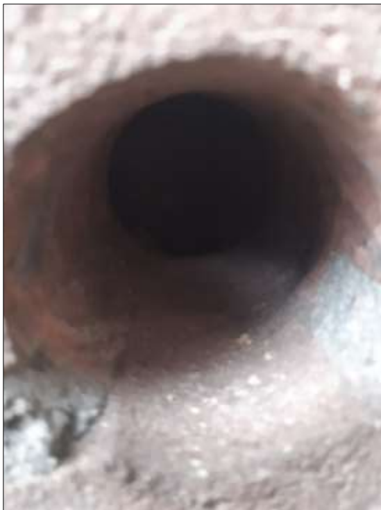
Foto 31 Gat muur aanbouw stal met isolatie
