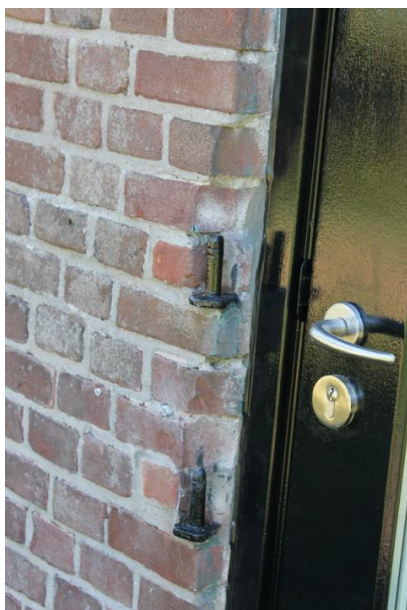
Nieuw deur is in kozijn geplaatst. De oude duimen zijn niet verwijderd
