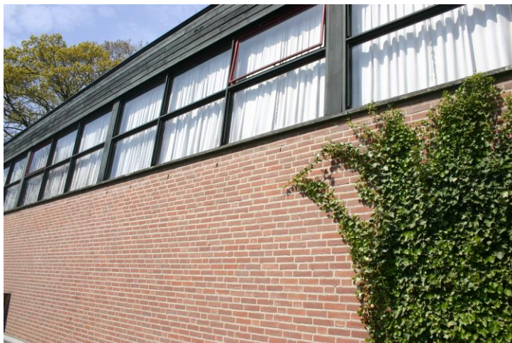
Figuur 4.5.2. De open stootvoegen onder de ramen aan de noordzijde zijn niet voorzien van roosters.
