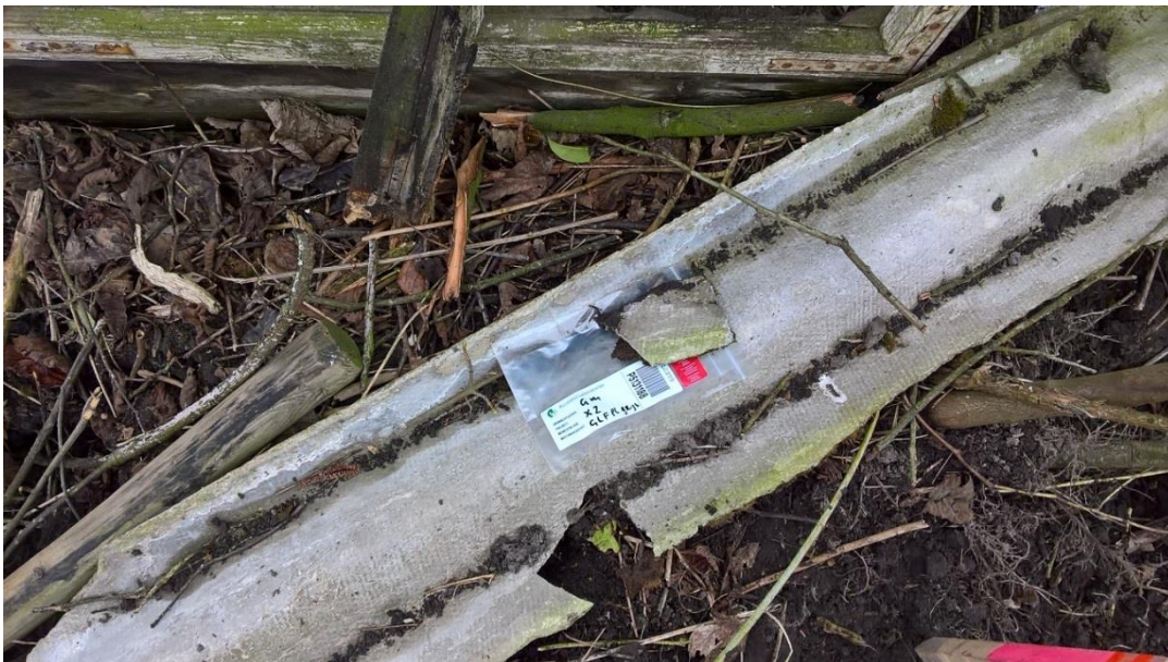
Figuur 4.1 Losse stukken asbest aangetroffen op het maaiveld
