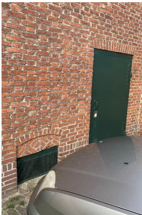
Afbeelding 3. Oostzijde transformatorhuis (rooster)
