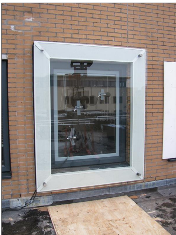
Foto II.3 Aanzicht glazen gevelgeluidscherm
