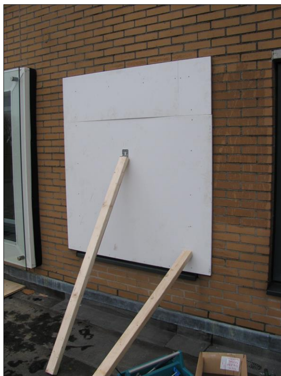
Foto II.4 Provisorische afdichting tweede raam
