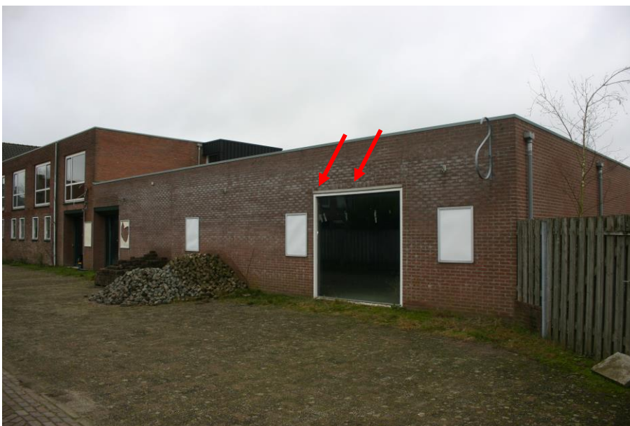
Figuur 4.4.4. De twee enige open stootvoegen in het gebouw (aangeduid met rode pijlen).
