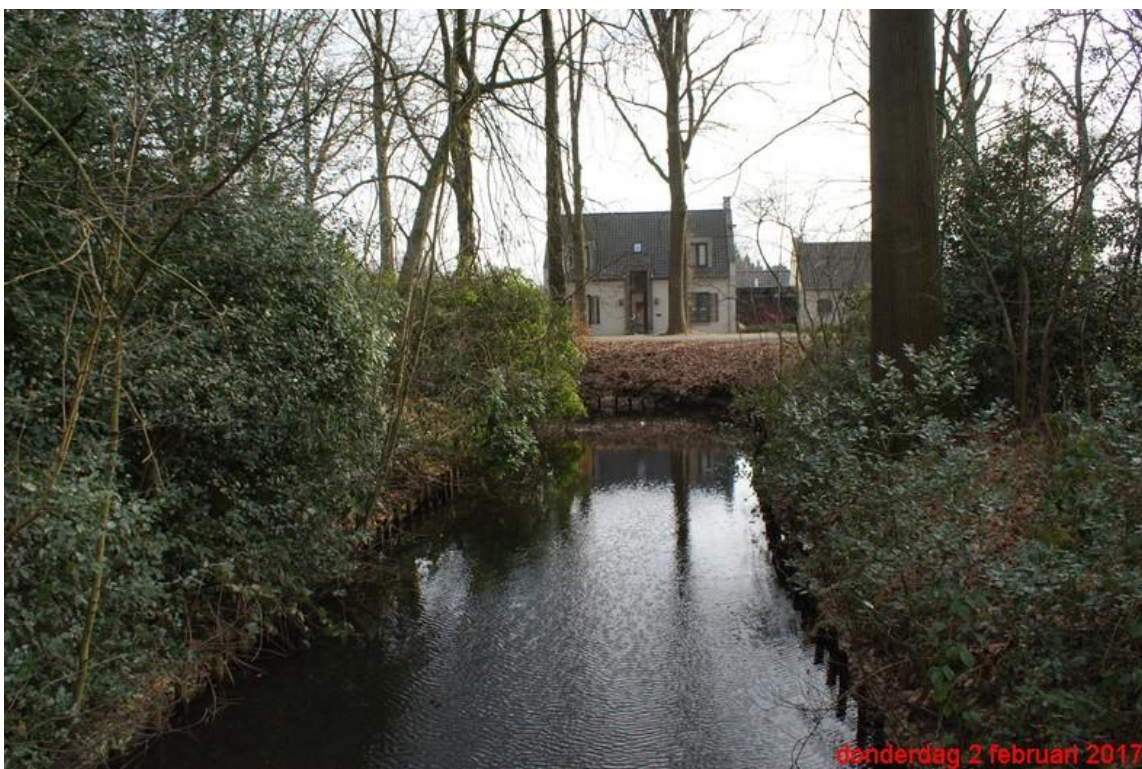
Zicht vanaf de brug in de richting van de Montfortlaan; over de gehele lengte vervallen beschoeiing en afgekalfde oevers
