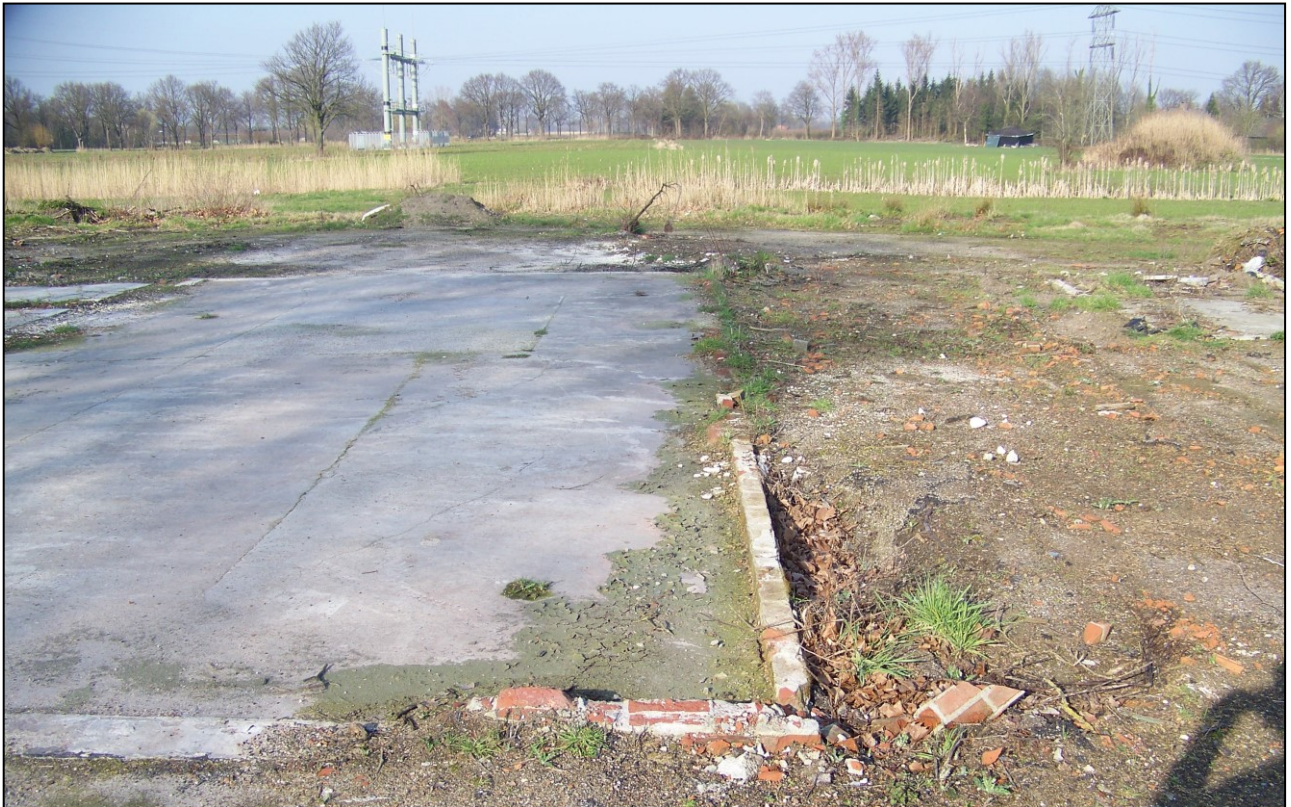
Afbeelding 4: Bestaande fundamenteën van de door brand teniet gegane bedrijfsgebouwen achter de bedrijfswoning
