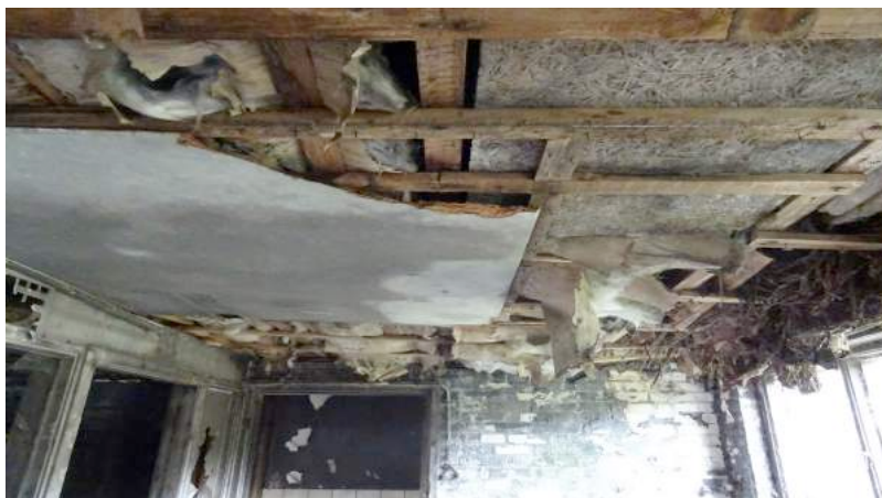
Deels ingezakt plafond
