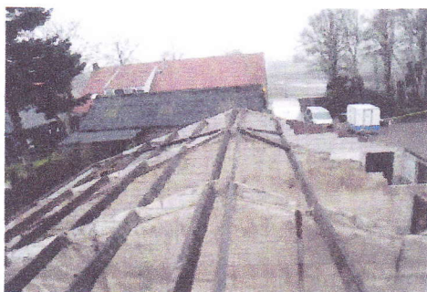
foto 1: Varkensstal. Gifplaten verwijderd. Deco. Inspectiegebied.
