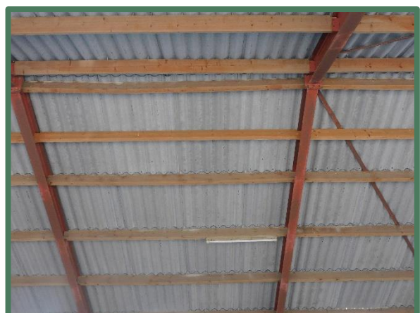
Niet geïsoleerd dak
