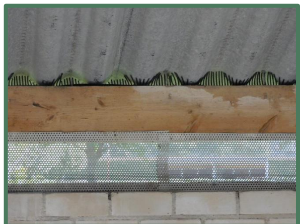
Vogelschroot onder golfplaten stalling
