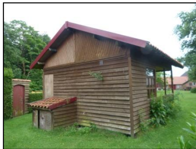
Figuur 13. Achterzijde tuinhuisje.
