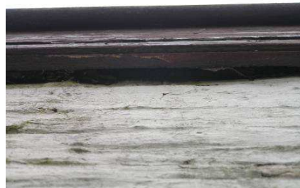
Grote kieren onder dakrand langs gehele huis die toegang geven tot het huis voor vleermuizen.
