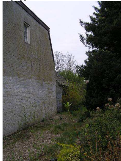
Zijkant woonhuis, onder dakrand wederom kieren.
