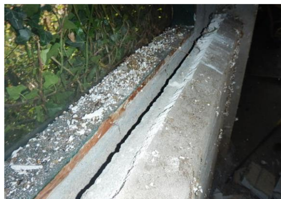
Glas los in sponning houten kozijnen
