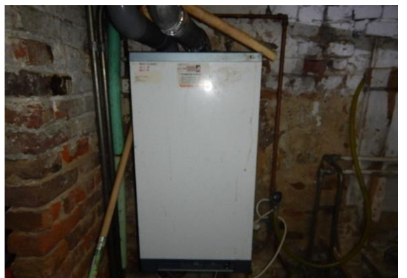
Moderne HR cv-ketel en moderne leidingisolatie
