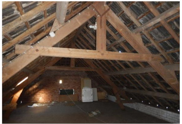
Houten spanten en geen dakbeschot
