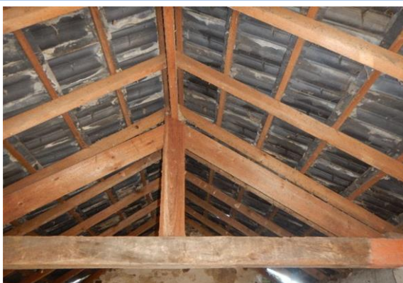
Geen dakbeschot onder de dakpannen
