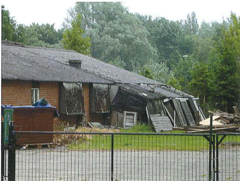
Foto 11: Dubbestraat 1, oude asbestdaken, kijkrichting zuiden
