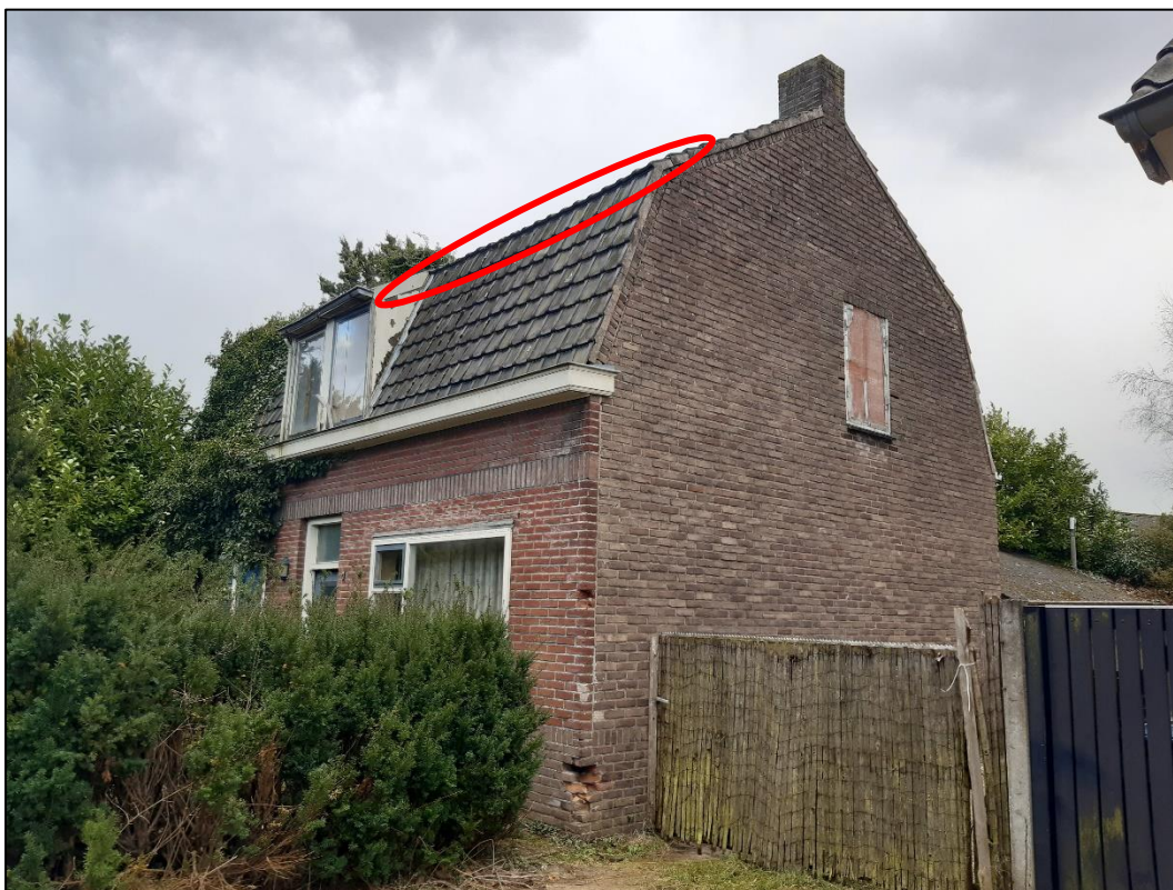
Foto 5: Woning met huisnummer 7. Bij de knik in het dak hebben vleermuizen mogelijk toegang tot het dak waar ze een verblijfplaats kunnen hebben (rood omlijnd).
