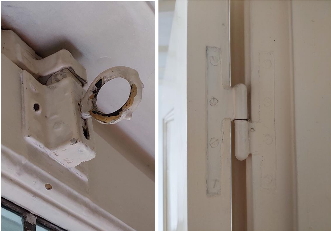
Oorspronkelijke ramen zijn overschilderd, en nog voorzien van hang- en sluitwerk uit de bouwtijd. Rechts is één van de (standaard) paumellescharnieren te zien waarmee deuren zijn afgehangen. Er werd met sleufschroeven gewerkt.
