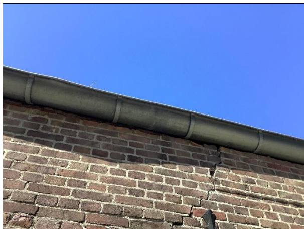
Foto 5 Scheur in het noordoostelijk deel van de bebouwing. Dit gedeelte zal worden gesloopt
