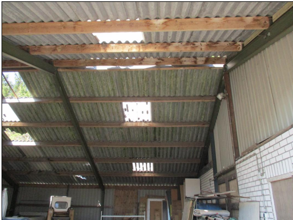
Figuur 4 De binnen zijde van de loods (C) met een golfplaten dak in een erbarmelijke staat.
