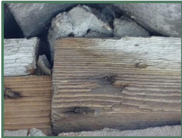
Oud bouwschuim direct op de muurplaat
