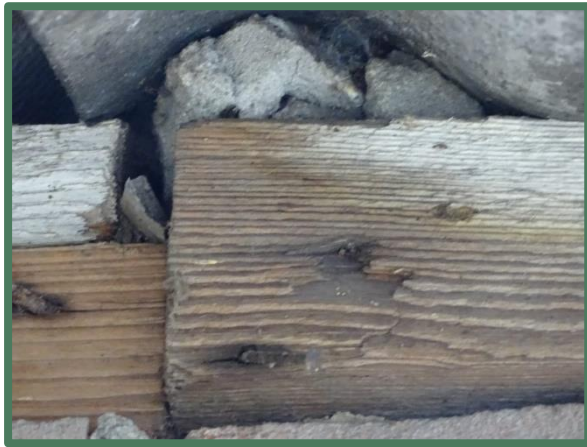
Oud bouwschuim direct op de muurplaat
