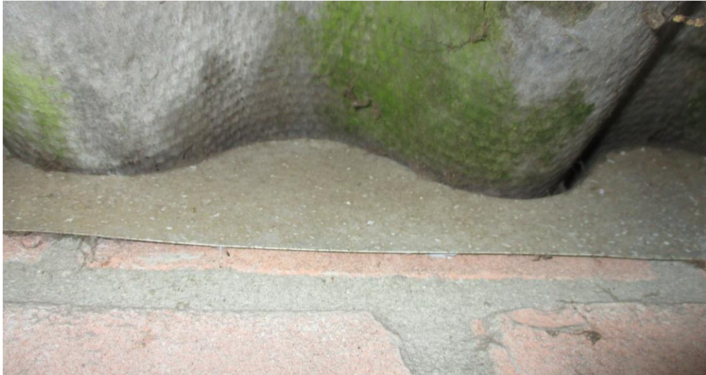
Figuur 6 De ruimte tussen de golfplaten en het dakruimte is ontoegankelijk door het aanbrengen van vogelverend materiaal.
