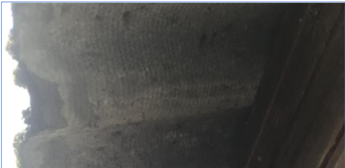
Figuur 4 Overhangende dakrand van de schuur, met zichtbare honingraat structuur.
