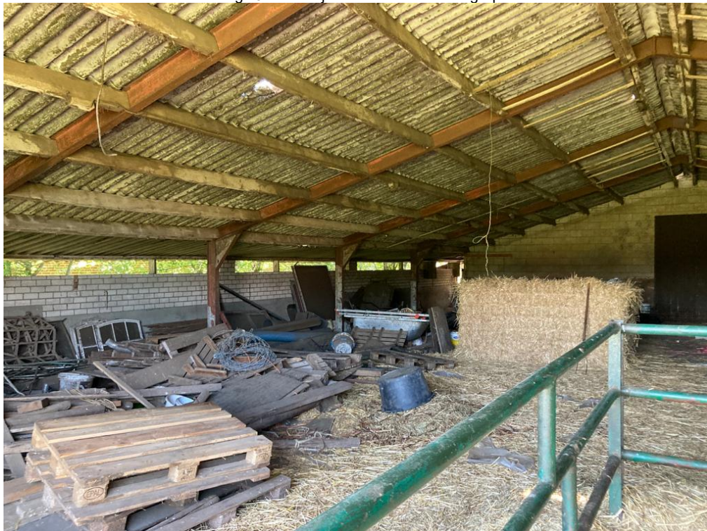
• Afbeelding 15: binnenzijde linker stal met enkel golfplaten
