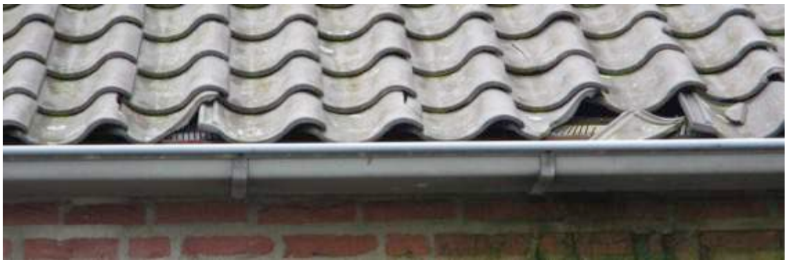
Figuur 3 De kapotte dakpannen aan de achterzijde van het concertgebouw.
