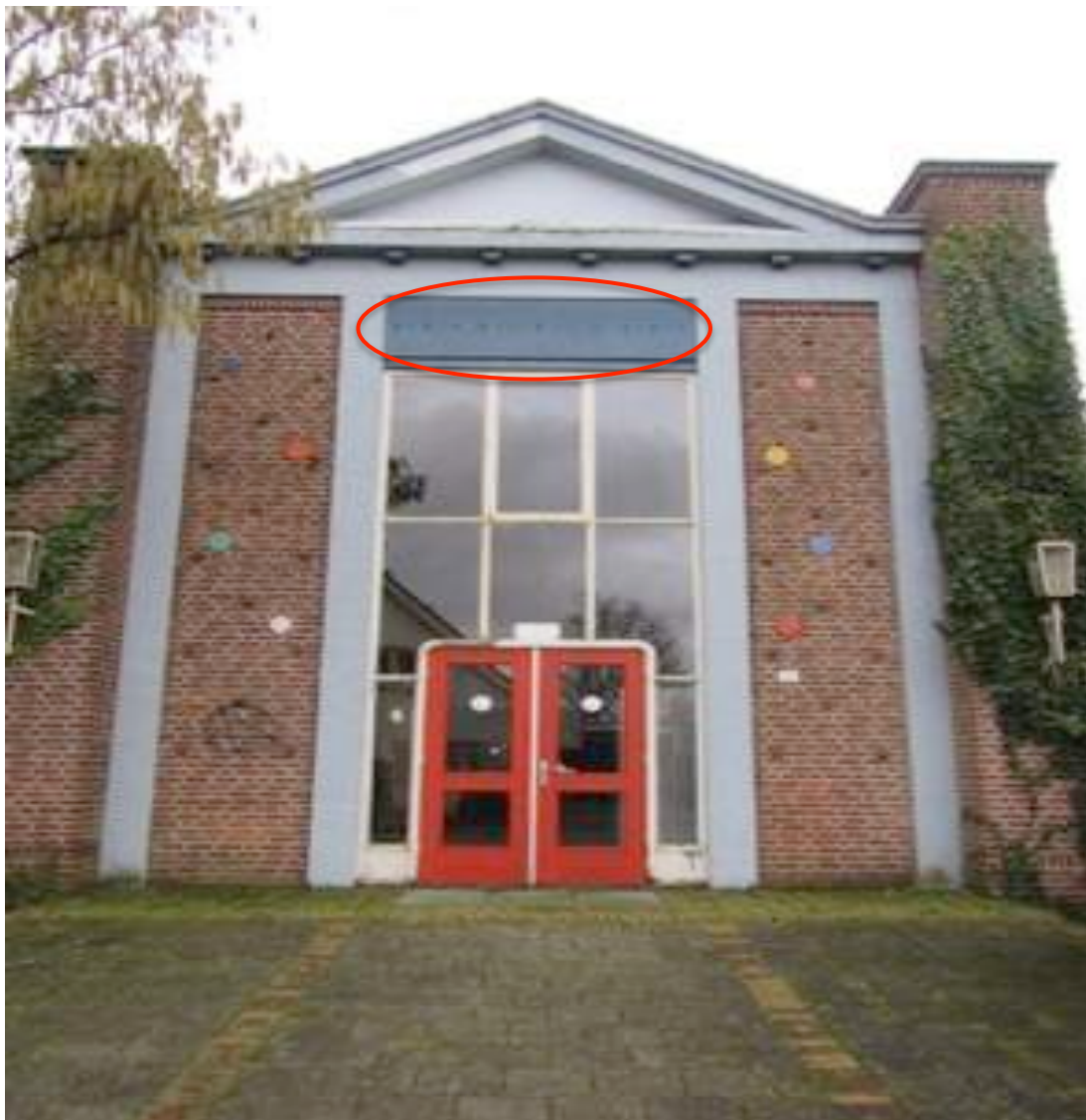
Figuur 2 Voorzijde concertgebouw, de openingen in de gevel bevinden zich binnen de rode cirkel.
