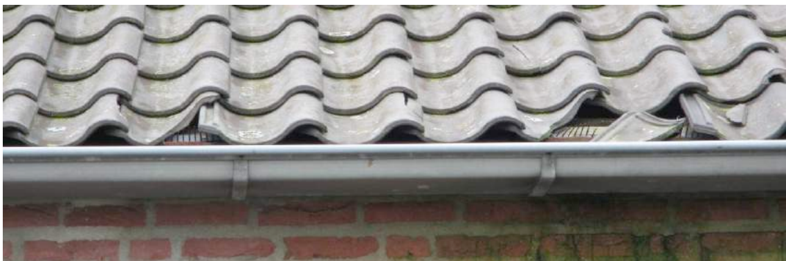
Figuur 6 Schade aan het pannendak met zichtbaar vogelschroot.
