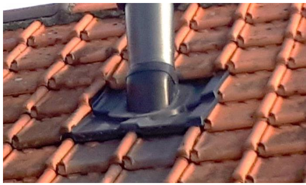
Figuur 8. Kleine openingen, zoals rond dak doorvoer, zijn plekken waar vleermuizen onder kruipen.
