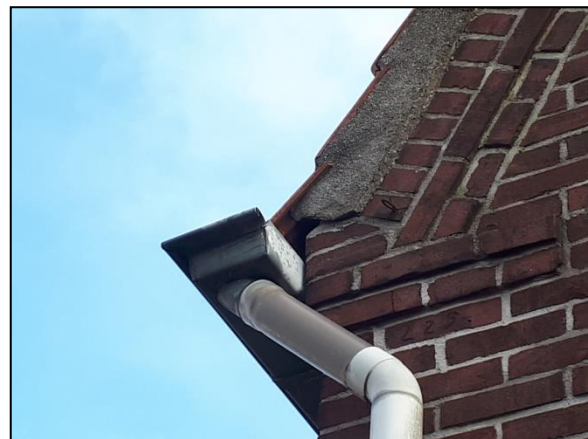
Figuur 6. Ruimte onder dakpan waar huismussen onder kunnen kruipen.
