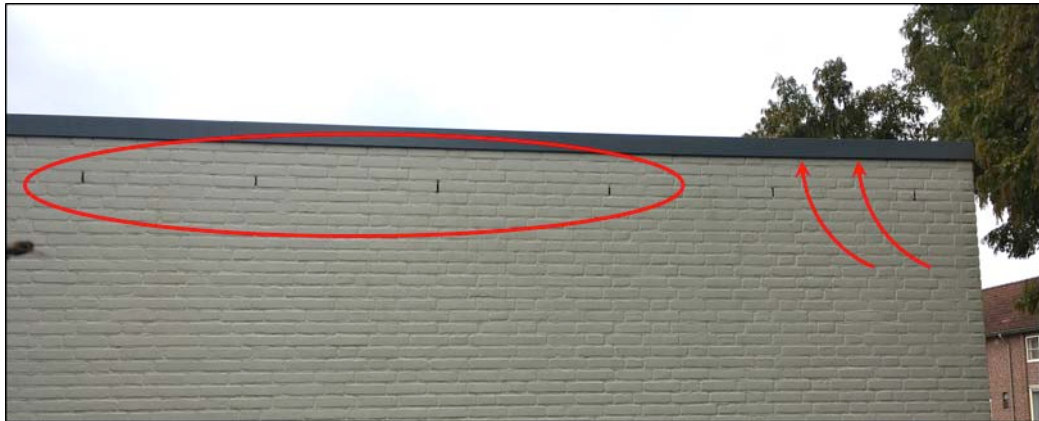
Figuur 2a Aangetroffen openingen welke (visueel beoordeeld) mogelijk zouden kunnen functioneren als toegang tot vaste rust- en/of verblijfplaats van gebouwbewonende vleermuizen.
