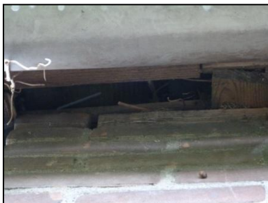
Figuur 14. Opening onder de dakgoot.
