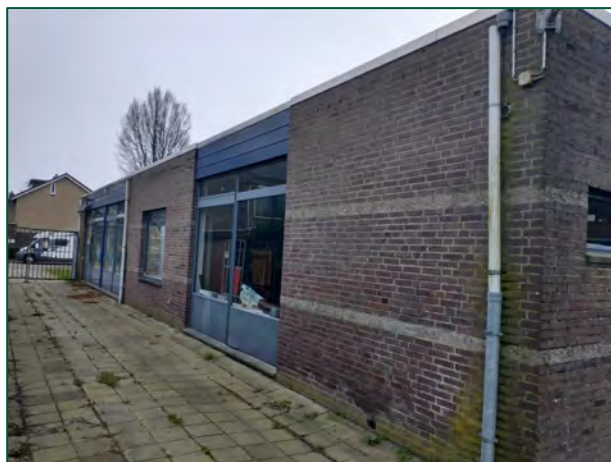
foto 9: wijkende dakrand bij het kinderdagverblijf
