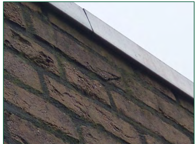
foto 4: Wijkende daklijst bij schoolgebouw
