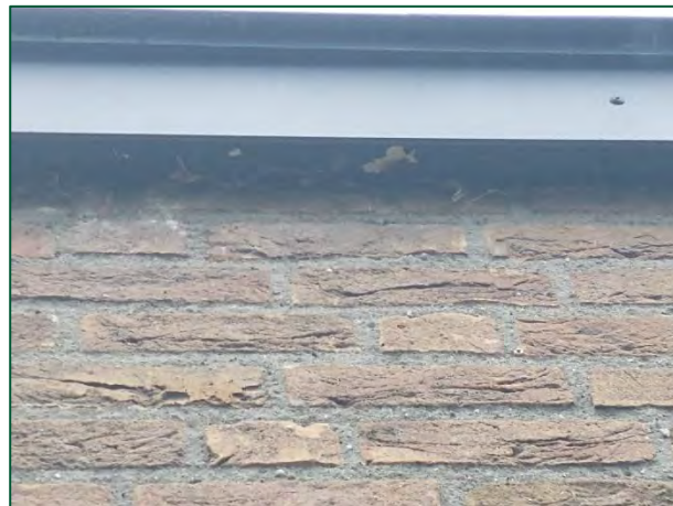
foto 10: Wijkende dakrand van het kinderdagverblijf, waarbij te zien is dat deze gedicht is.
