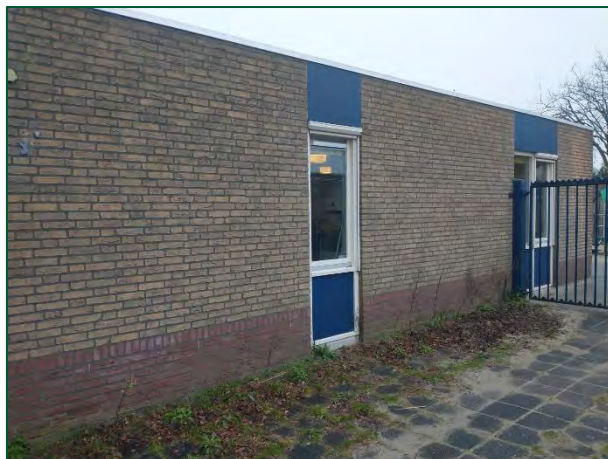
foto 8: gevel van het kinderdagverblijf waarop te zien is dat er geen stootvoegen aanwezig zijn
