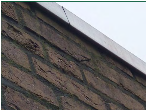
foto 11: wijkende dakrand bij het kinderdagverblijf
