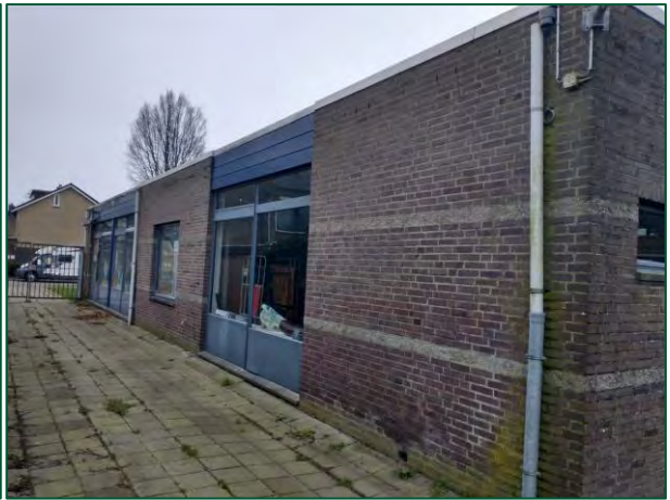
foto 3: Schoolgebouw met stootvoegen, ruimte tussen de dakstrip en muur
