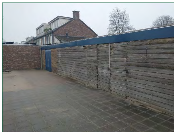
foto 13: voorzijde van de opslag op het terrein van het kinderdagverblijf. de opslag is afgedicht met houten planken waarvan er enkele kieren
