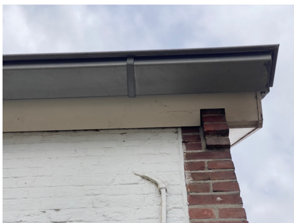
Figuur 14 Detailfoto gevelbetimmering onder de dakgoot, deze sluit niet goed aan waardoor er genoeg ruimte is voor soorten om onder te nestelen.
