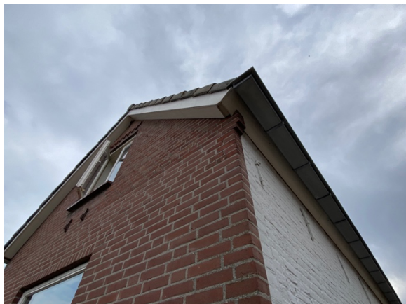
Figuur 12 Voorkant woonhuis met toegankelijke ruimtes onder de dakpannen, dakgoot en gevelbetimmering.
